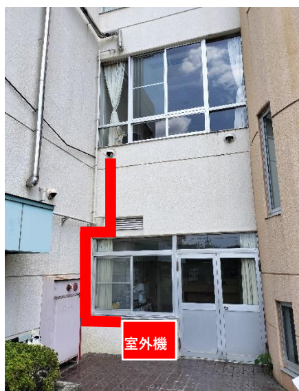
室外機設置場所
