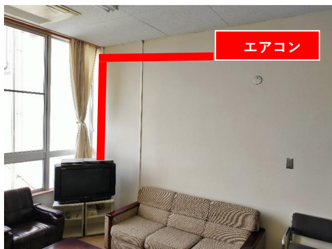
エアコン設置場所
