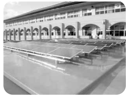
▲太陽光パネルが設置されている市立西中学校
