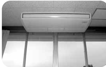
▲小学校に設置されたエアコン
