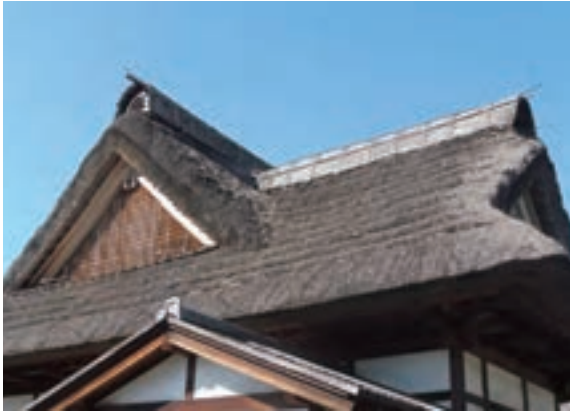
老朽化した庫裡板葺屋根の状況
