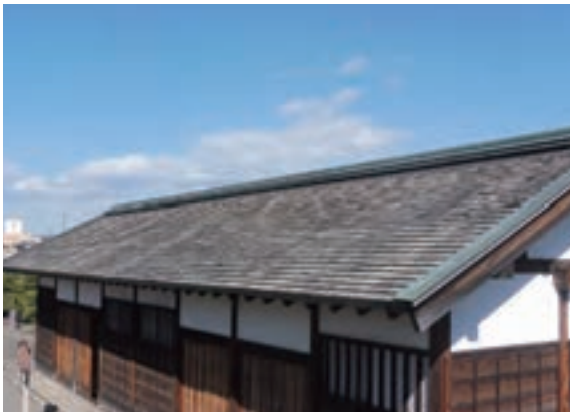
衆寮板葺屋根の劣化状況
