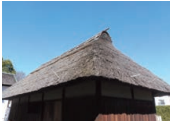
木小屋の茅葺屋根の劣化状況
