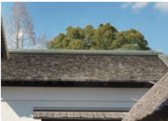
土蔵板葺屋根の劣化状況
