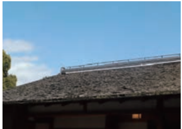
書院板葺屋根の劣化状況
