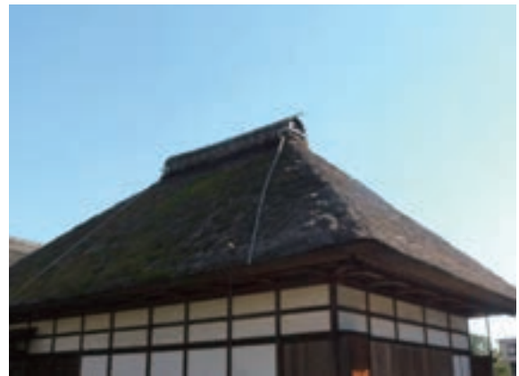
老朽化した方丈茅葺屋根
