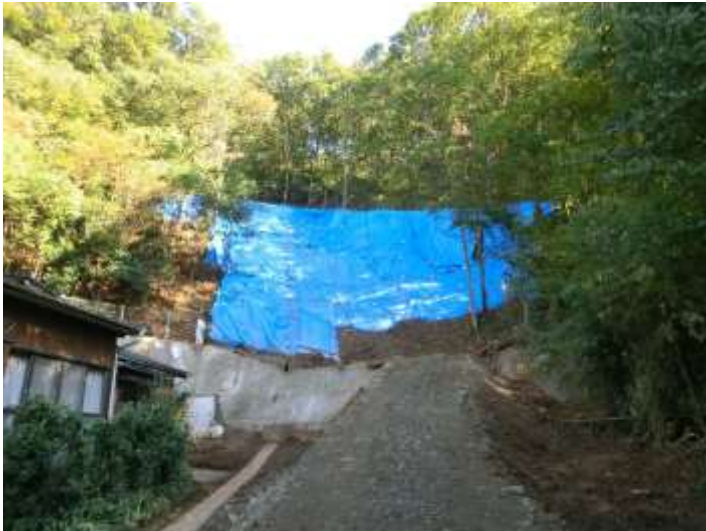
助戸大橋町 土砂災害現場
