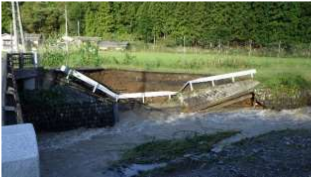
小俣町 春日橋付近の護岸洗堀
