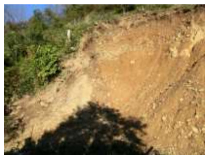
土砂災害箇所(樺崎町)
