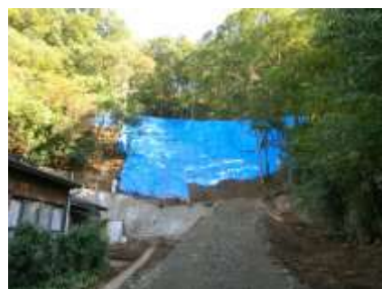
土砂災害箇所(助戸大橋町)
