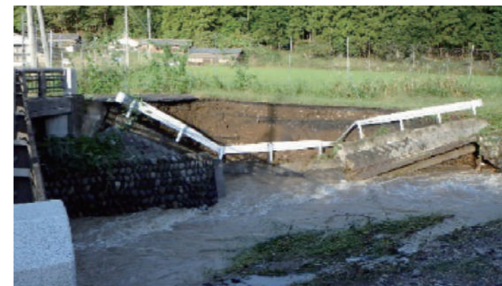
春日橋付近の護岸洗掘(小俣町)
