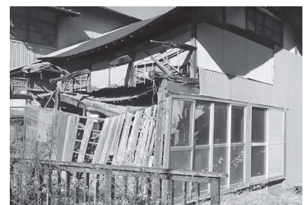
▼危険な空き家の外観
