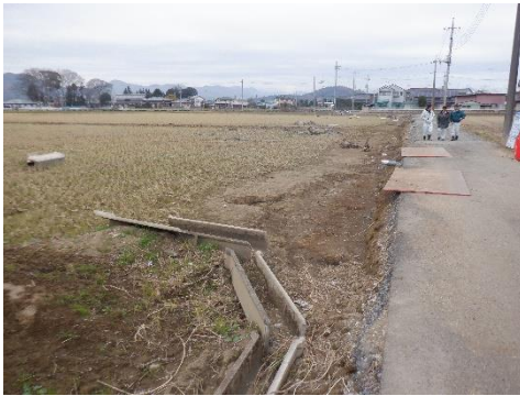
稲岡町 農業用水路破損
