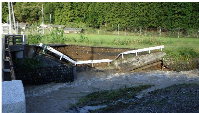
小俣町 春日橋付近の護岸洗堀
