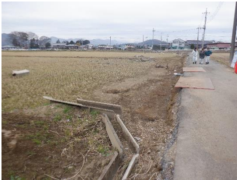
稲岡町 農業用水路破損
