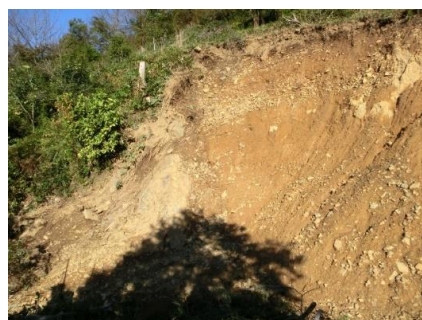
土砂災害箇所(樺崎町)
