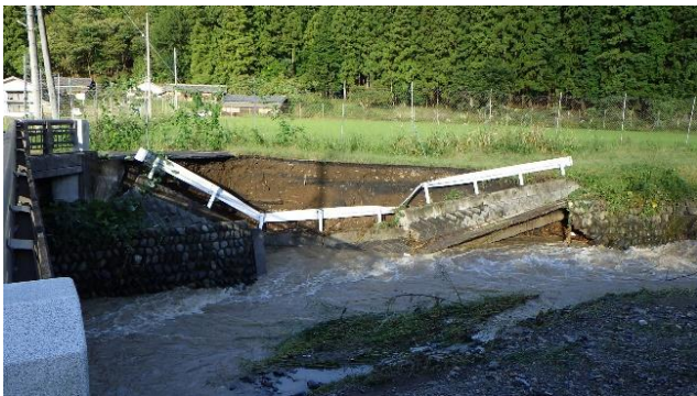
小俣町 春日橋付近の護岸洗堀
