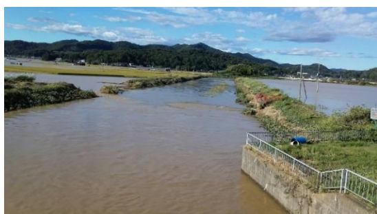
決壊した出流川(寺岡町)
