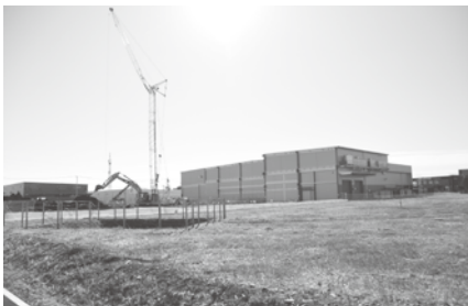
▲立地企業の建設が続々と始まるあがた駅南産業団地
