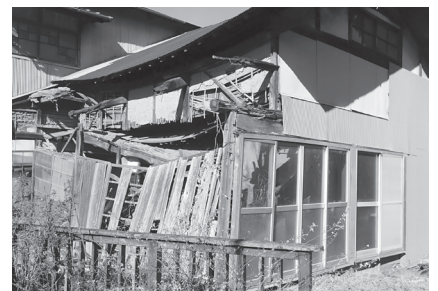
▼危険な空き家の外観
