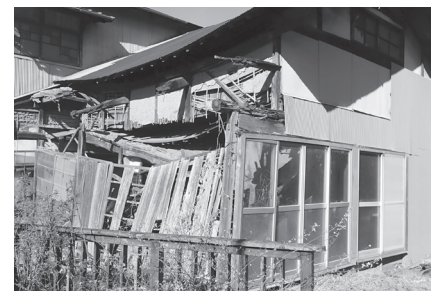
▼危険な空き家の外観
