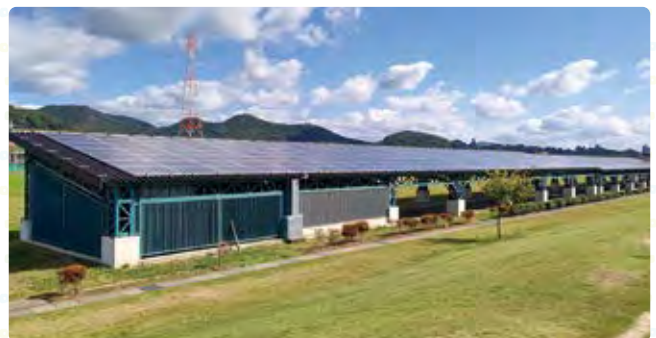
メガソーラー（足利市太陽光発電事業第一発電所）
